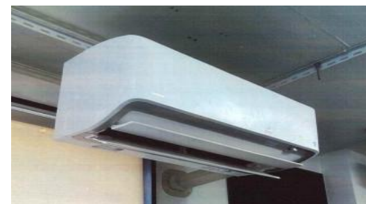
民間事業所のエアコン設置
