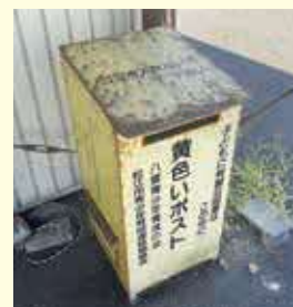
▲塗り直し・修繕前
