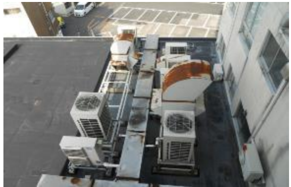
写真10 第4別館 屋上にある設備機器 設備機器は耐用年数を経過している。屋外にある機器は錆が見られる。
