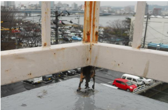
写真9 別館 外部金物の腐食 外部の金物（手すりなど）が錆により腐食している。
