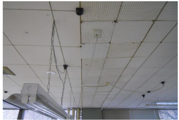
写真8 本館 2階天井 木下地で、たわみがある。漏水痕が随所にある。壁はクラックが多数あり、モルタルも浮いている。
