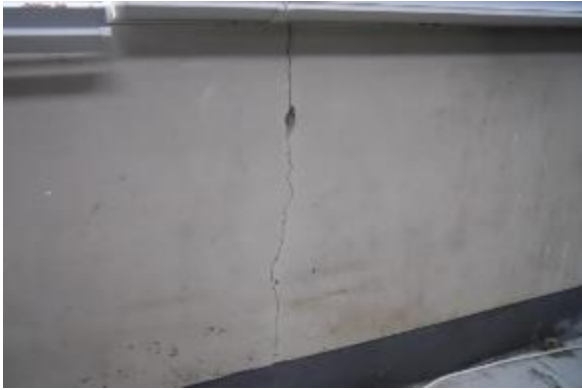
写真7 本館 内部壁 屋内壁や梁型・柱型にもクラックが見られる。
