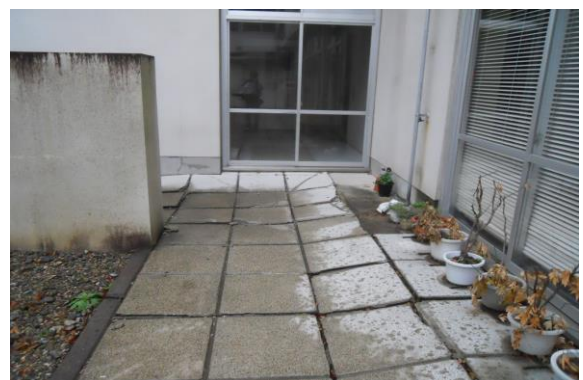
写真6 本館 中庭の地盤沈下
