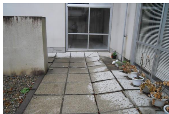
写真6 本館 中庭の地盤沈下
