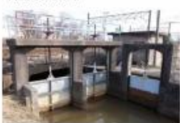
八幡排水機場(水2号)
