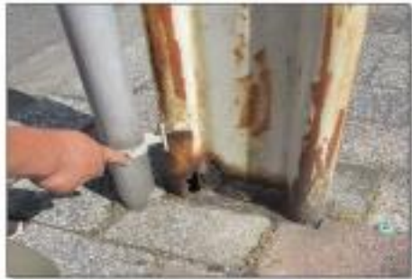
【バス停上屋の機能向上 上屋老朽化の状況】
