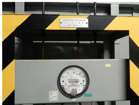
(2) 外気処理装置フィルタ差圧計
