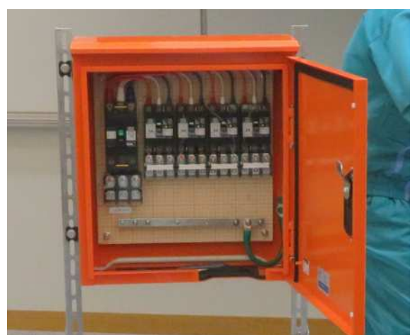
金属製の仮設分電箱
