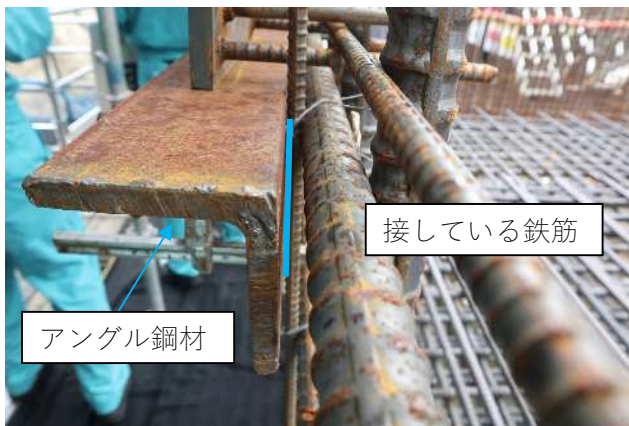
アングル鋼材と鉄筋が面で接している
