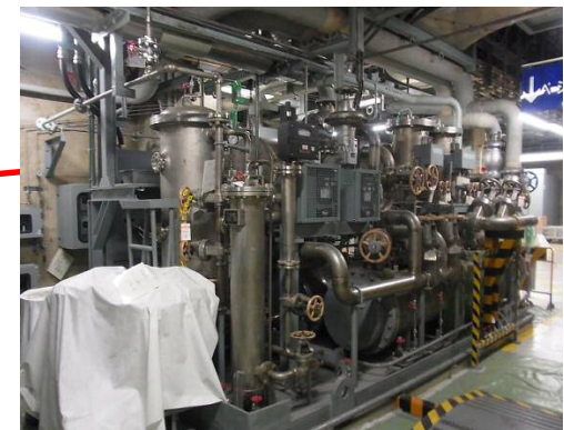
固定子冷却設備※
