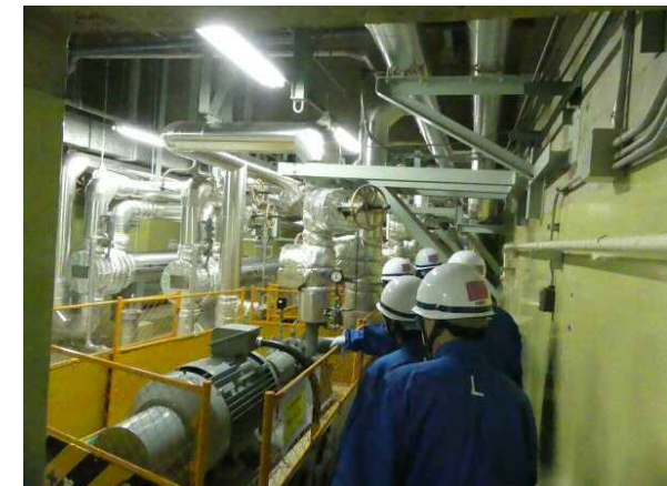
(写真2) 燃料プール冷却水ポンプの 維持管理状況確認
