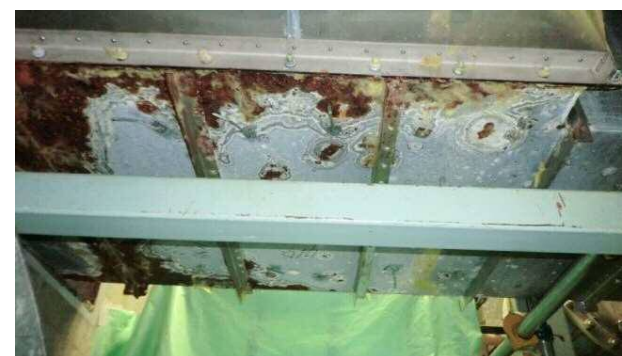
3箇所の腐食の一例
