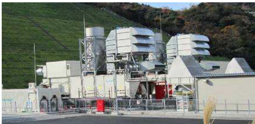
▲約40mの高台に設置したガスタービン発電機 (12000kW級×2台)
