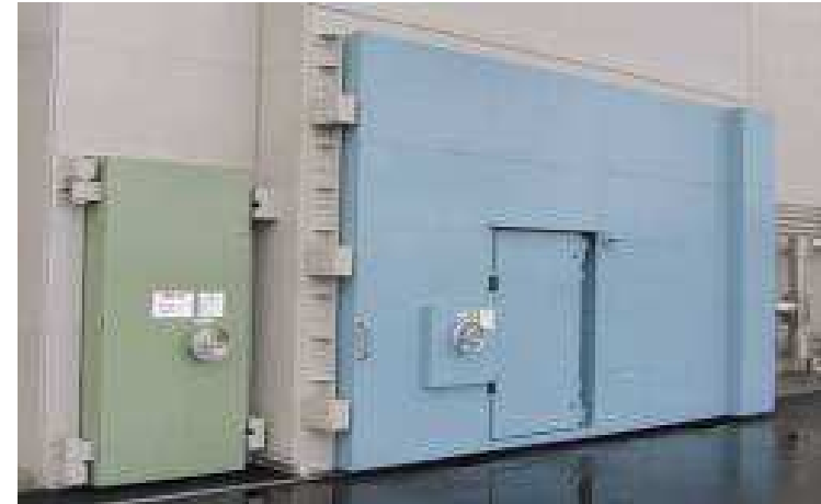
▲3号機建物外壁に設置した水密扉
