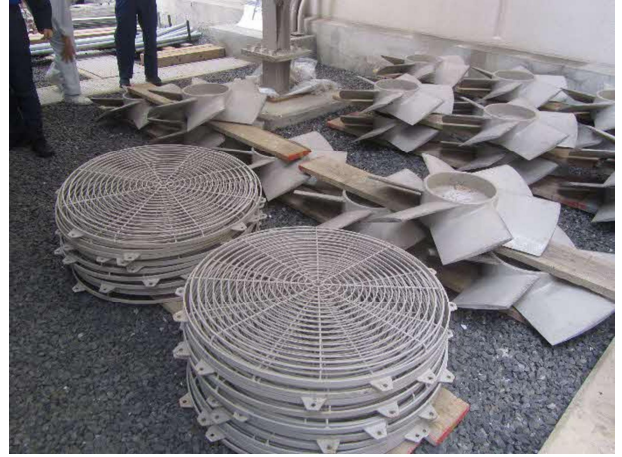
取り外された冷却ファン
