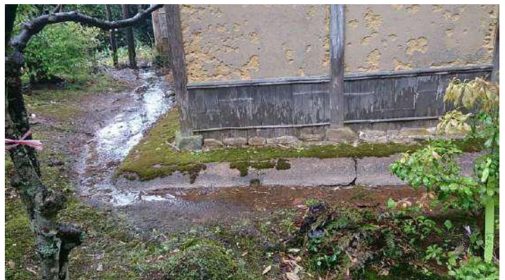
写真 56 降雨時の御風呂屋の滞水状況 平成26(2014)年撮影
