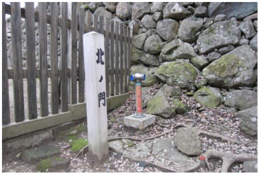
送水口（北ノ門）
