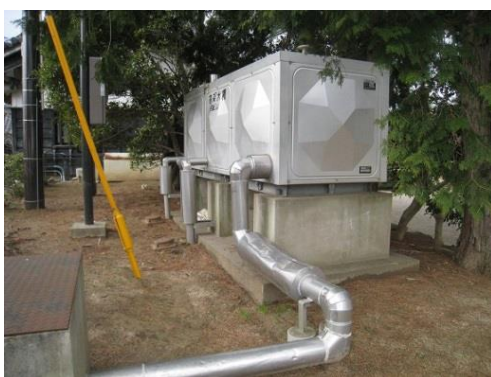
写真 3-2 本丸内の多聞東側の高架水槽
