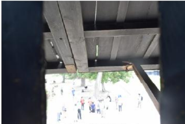
写真11：突上戸の板には割れが見られる。
