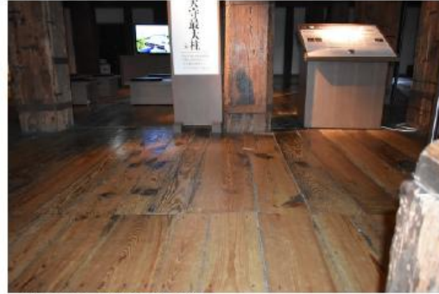
写真10：床板不陸状況。
