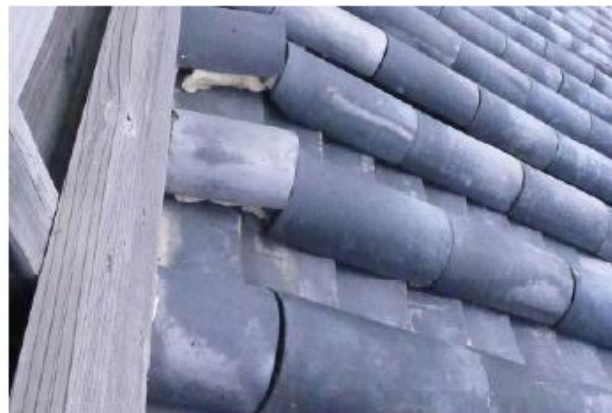
写真2：4層屋根の葺き止めの瓦が浮いている。
