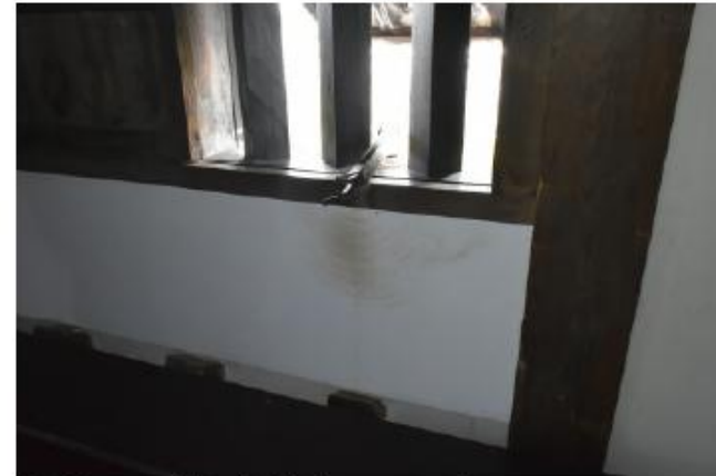
写真12：鎖の痕が養生ベニヤに残る。
