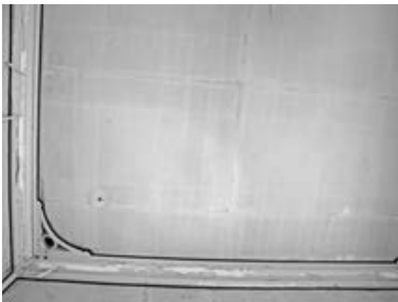
写真3-1-12 張付天井の汚損
