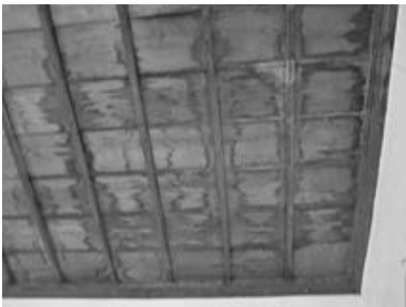
写真3-1-5 天井の雨染み
