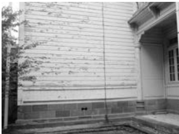
写真3-1-11 ペンキの剥落
