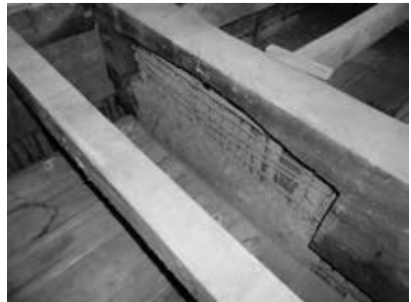
写真3-2-7 ⑥：梁下端の欠き込み
