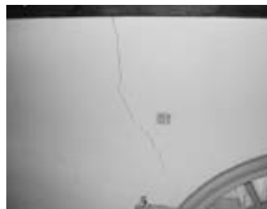
写真3-1-10 漆喰のクラック
