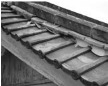
写真3-1-1 面戸漆喰の破損
