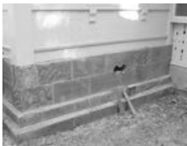
写真3-1-8 基礎布石の剥離
