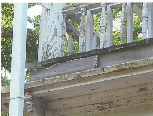
(写真 9-3) 2階ベランダ床面、底面の劣化
