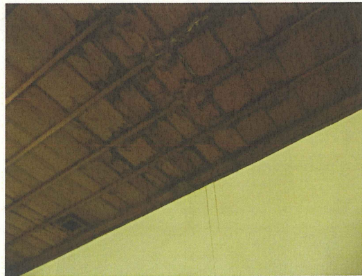
(写真 5-2) 2階天井面の雨漏り痕跡
