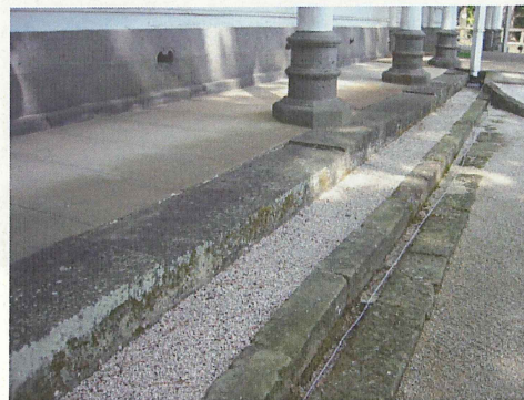
(写真 2-1) 基壇島石、雨落石の不陸
