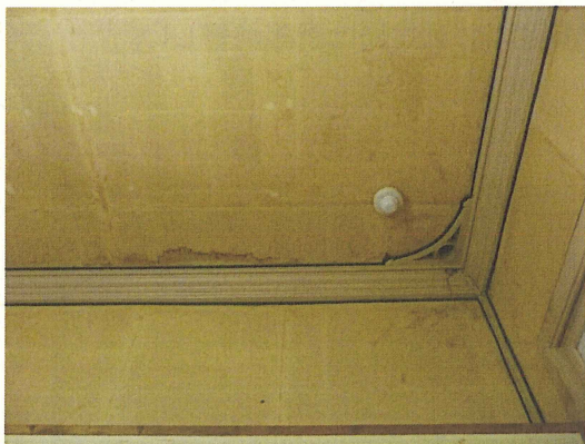
(写真 5-1) 2階貴顕室天井の雨漏り痕跡
