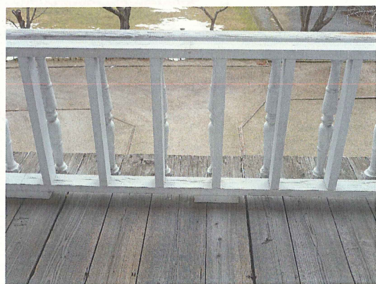
(写真 9-4) 2階ベランダ手摺塗装の剥落
