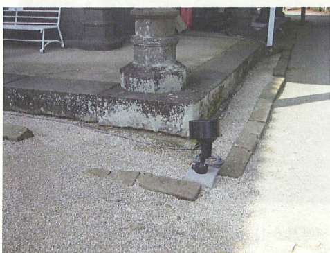
(写真 2-2) 雨落石の不陸
