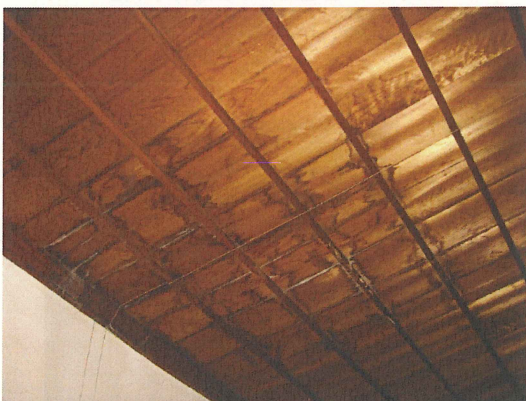
(写真 5-3) 2階天井面の雨漏り痕跡
