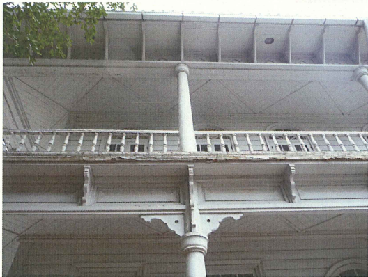
(写真 9-1) 2階ベランダ床面、底面の劣化
