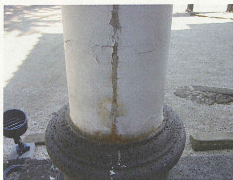
(写真 3-1) 木材と塗膜の収縮差によるクラック(列柱)
