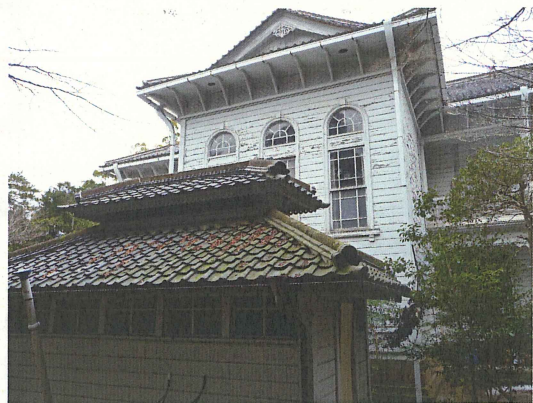
(写真 9-2) 階段外壁塗装の剥落
