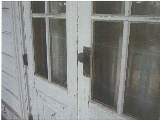
(写真 8-1) 建具の塗装劣化
