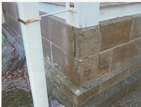
(写真 1) 腰石の剥離
