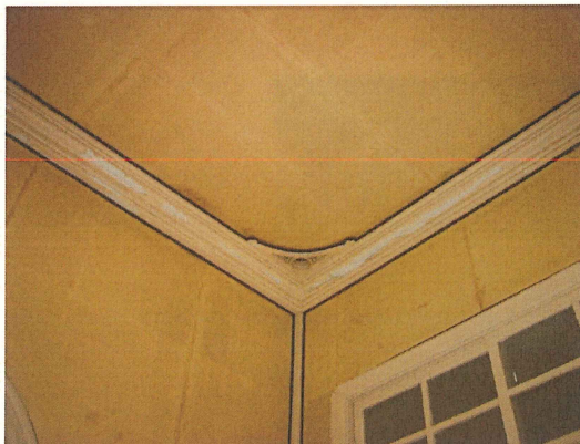
(写真 7) 2階貴顕室張付壁の汚損 (無地鳥の子紙仕上げ)
