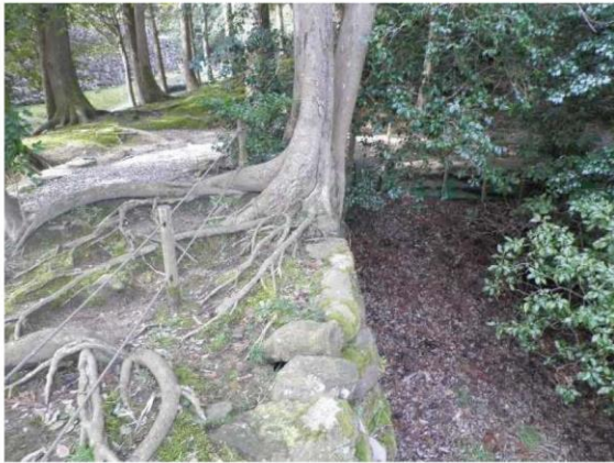
石垣上部、石垣に根が絡んだ樹木
