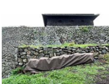
▲腰曲輪石垣の孕み出し
