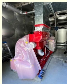
ポンプ室 内空冷ディーゼルエンジン
