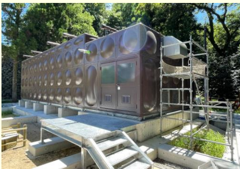
ステンレス製パネルポンプ室付水槽 茶色に塗装
