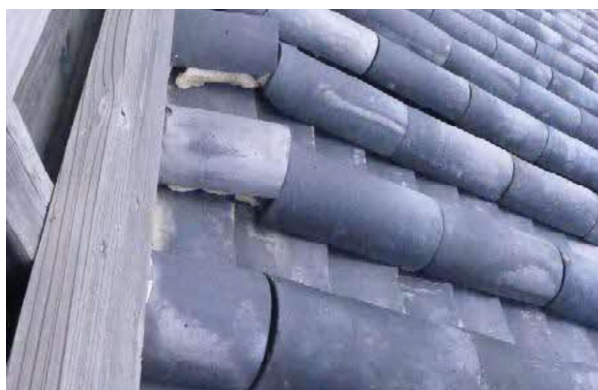
四重屋根(瓦が浮いている)
