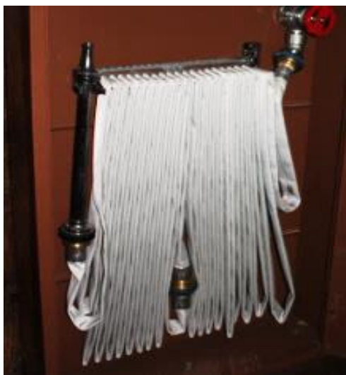
現状の設備 1号消火栓
