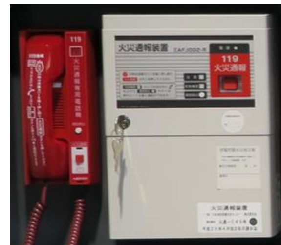
火災通報装置
