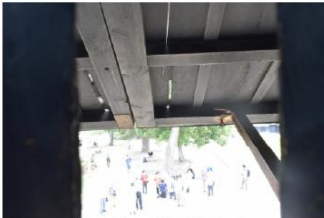
写真11：突上戸の板には割れが見られる。
