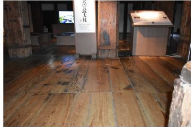
写真10：床板不陸状況。
