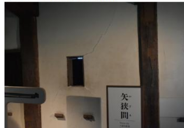
写真8：狭間や建具枠より斜めにひび割れている箇所が見られる。
