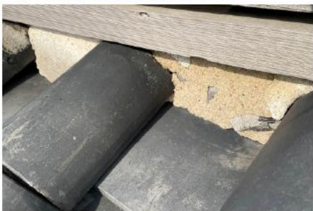
写真3：面戸漆喰の剥離状況。
