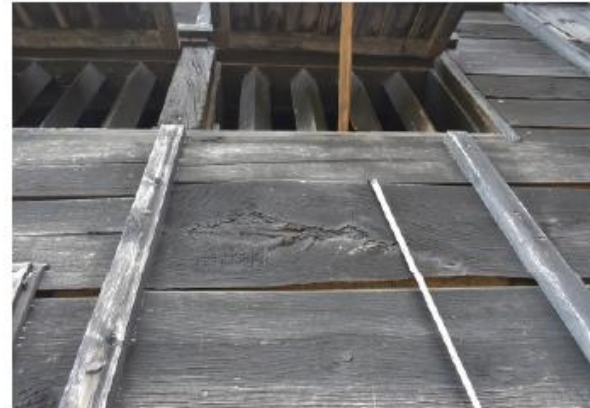
写真6：下見板の変形による隙間
