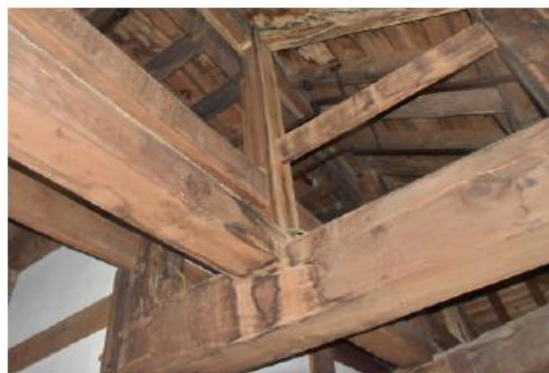
写真4：写真2の下部において雨漏りが発生している。
