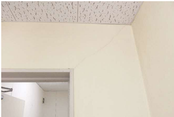
写真 43 開口部まわりのクラック
