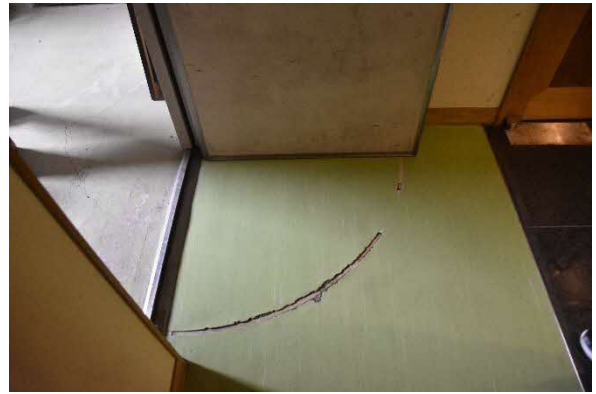
写真 48 扉の開閉による床の傷
