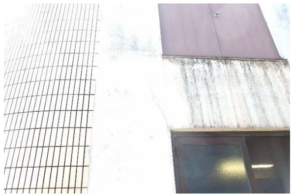
写真 28 開口間まわりの躯体のクラック
