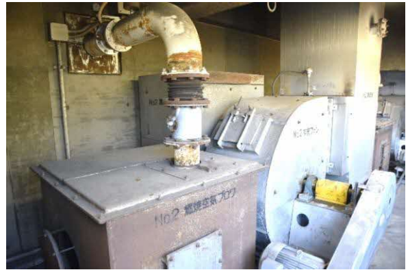
写真 72 2系列排気設備
