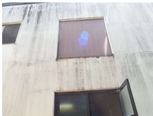
写真 80 2 階部分マシンハッチ
