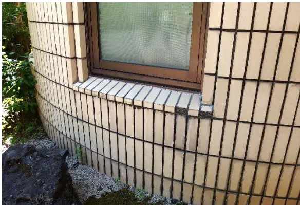
写真 29 窓部分のタイルの落下
