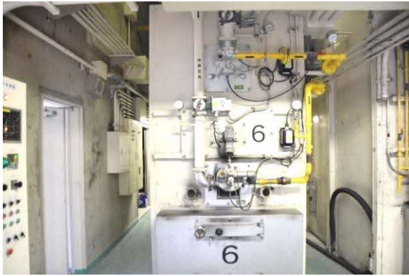
写真 61 6号炉の制御盤は別置き
