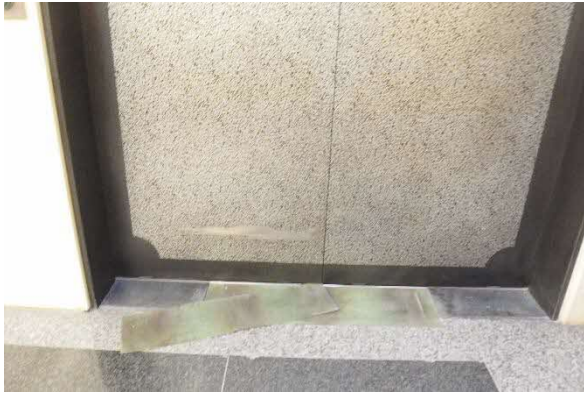
写真 47 炉前化粧扉のこすれによる剥がれ
