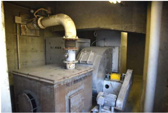
写真 71 1系列排気設備
