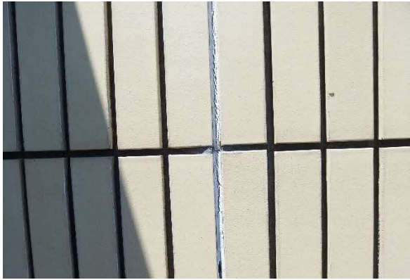
写真 27 タイル目地のコーキングの劣化
