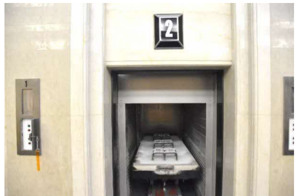
写真 66 2号炉前室と耐火台車
