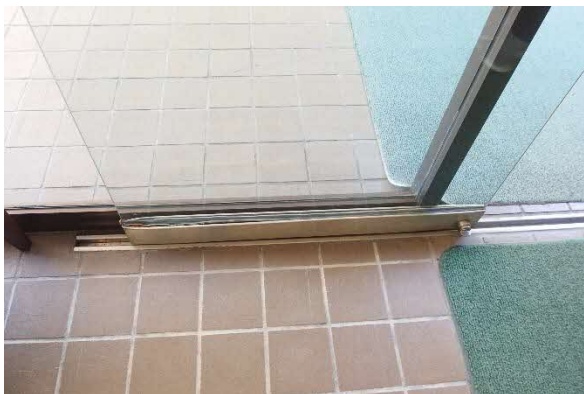
写真 45 入口部分の扉は錆により膨張
