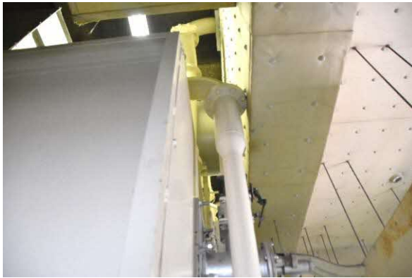
写真 63 エアー配管の取回しが厳しい
