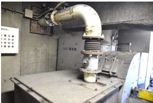
写真 73 3系列排気設備
