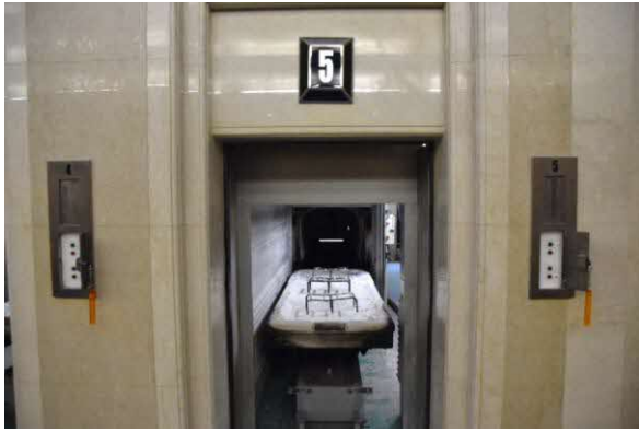
写真 69 5号炉前室と耐火台車
