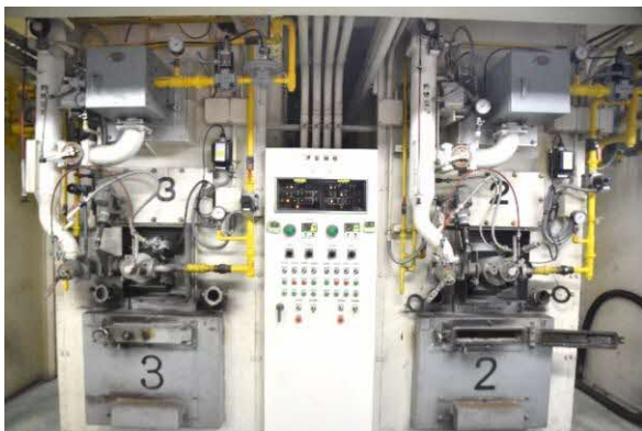
写真 59 2号炉と3号炉は共有の制御盤
