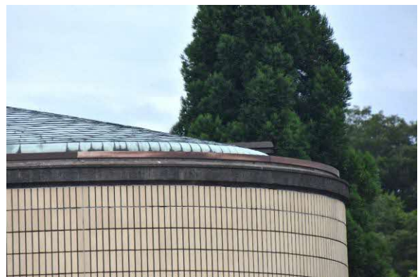
写真 34 笠木の劣化がみられる
