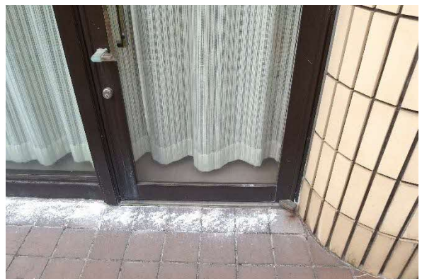
写真 46 待合ホール扉のヒンジの錆
