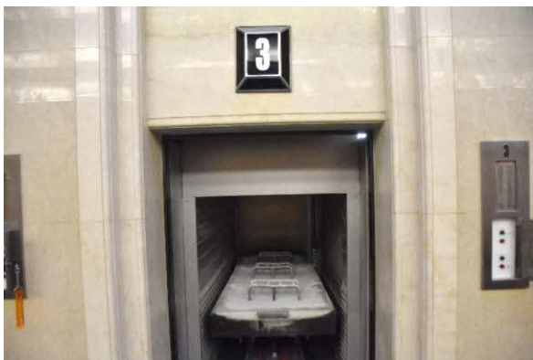
写真 67 3号炉前室と耐火台車
