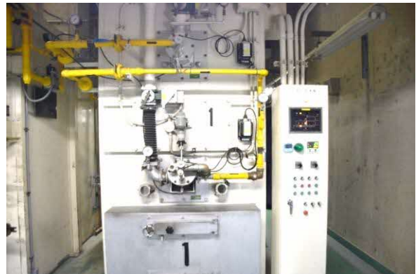
写真 58 1号炉と制御盤
