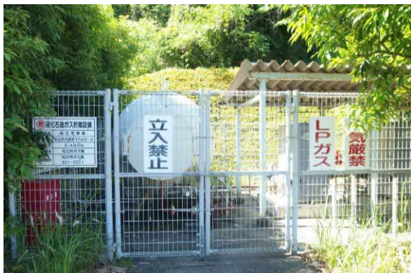
写真 77 LPガスバルクタンクと供給設備
