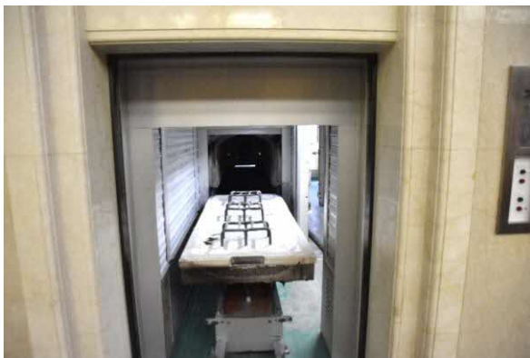
写真 65 1号炉前室と耐火台車
