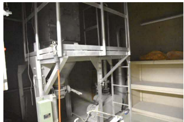
写真 76 残灰処理装置
