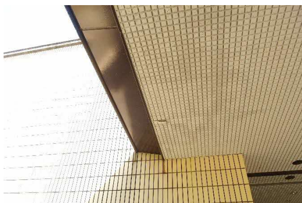
写真 25 車寄せの雨漏りと思われる染み
