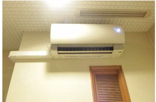
写真 52 後付けのエアコン
