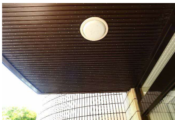
写真 26 玄関ホール軒天は外観上は問題無
