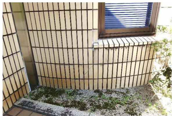
写真 30 タイルのクラック
