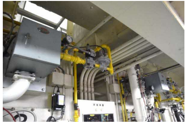
写真 64 ガス配管と電気配管が入り乱れる
