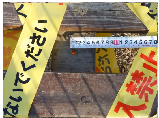
ネジの脱落した箇所
