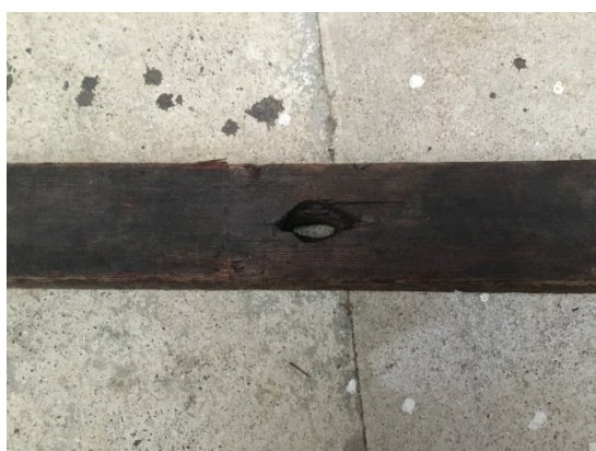
留め具が欠落した座板の状況
