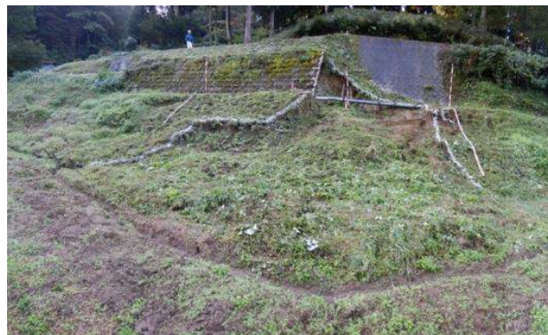
水路法面崩落 (玉湯町大谷)
