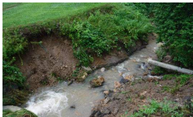
大谷排水路護岸崩落 (東忌部町)
