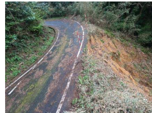
林道里路線法面崩落 (島根町野波)
