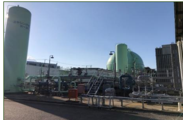
ガス生産設備
