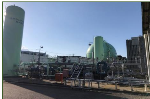
ガス生産設備
