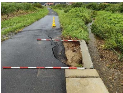
下宇部尾中央線法面崩落（美保関町下宇部尾）
