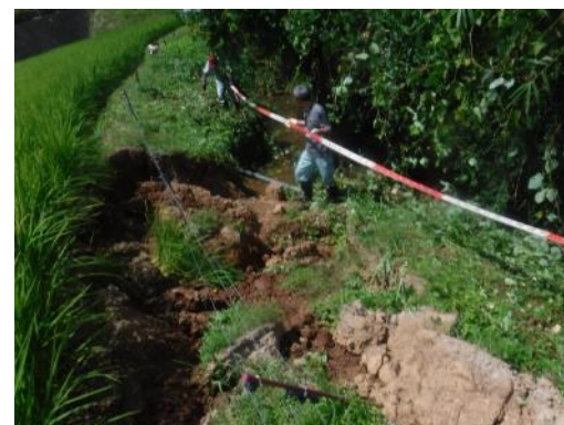
奥谷川護岸崩落（八雲町平原）
