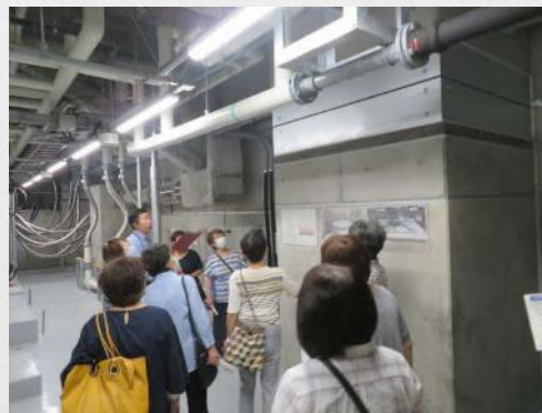
地下(免震装置)
