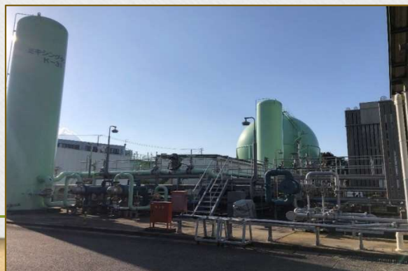
ガス生産設備
