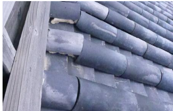
四重屋根 (瓦が浮いている)
