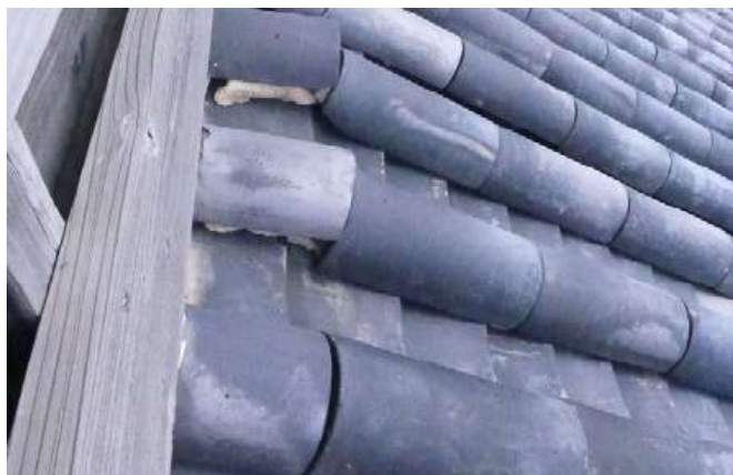
四重屋根(瓦が浮いている)
