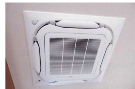
福祉施設の空調更新
