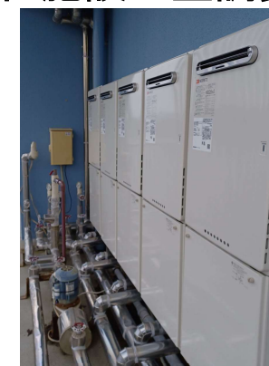
福祉施設の給湯器更新
