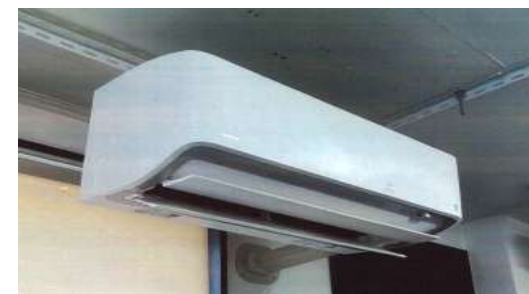
民間事業所のエアコン設置
