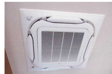
福祉施設の空調更新
