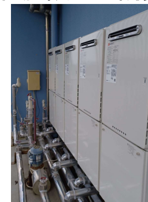
福祉施設の給湯器更新
