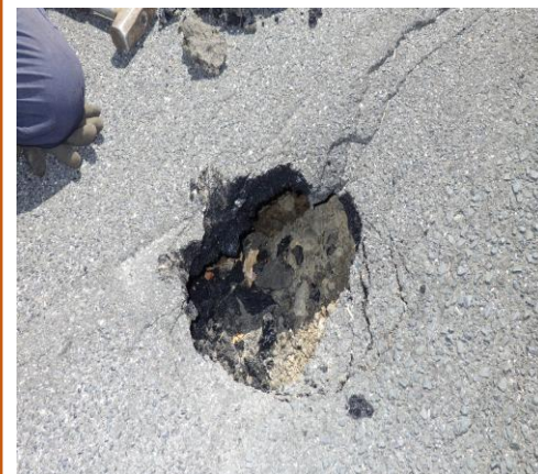
道路 路面の陥没
