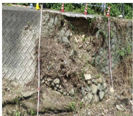
河川 護岸の崩落
