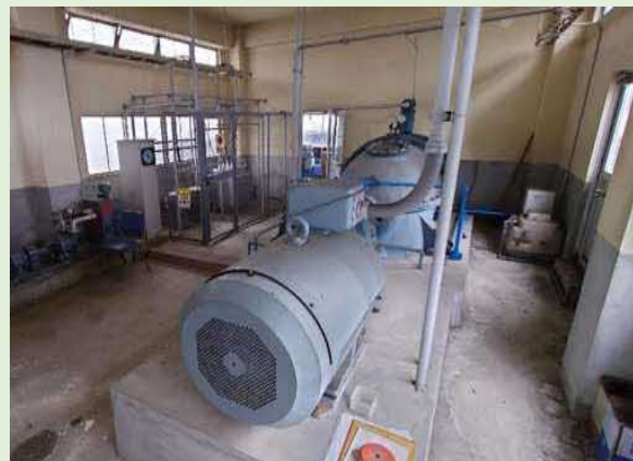
末次排水機場既設ポンプ
