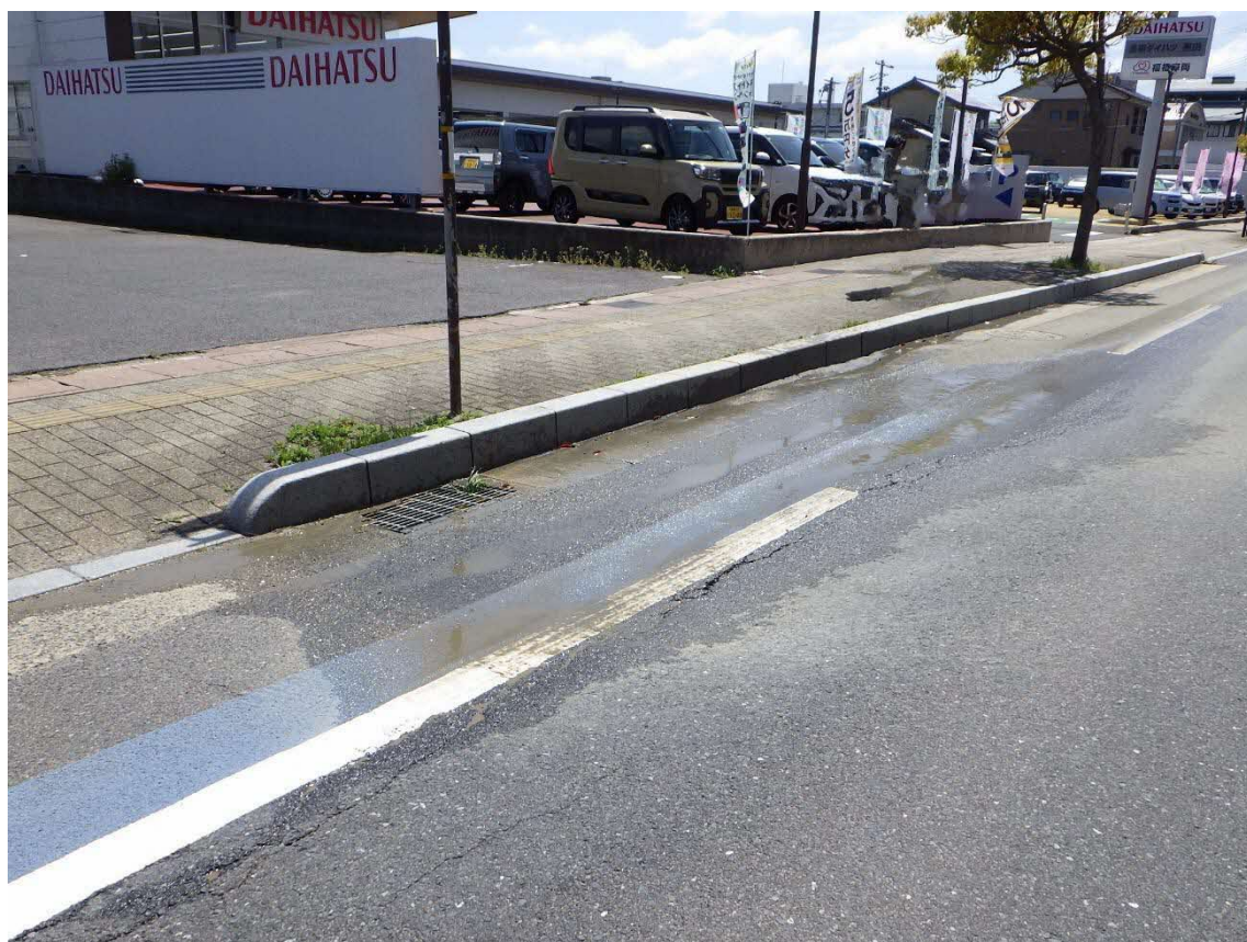
<黒田町汚水漏れ箇所：写真>
