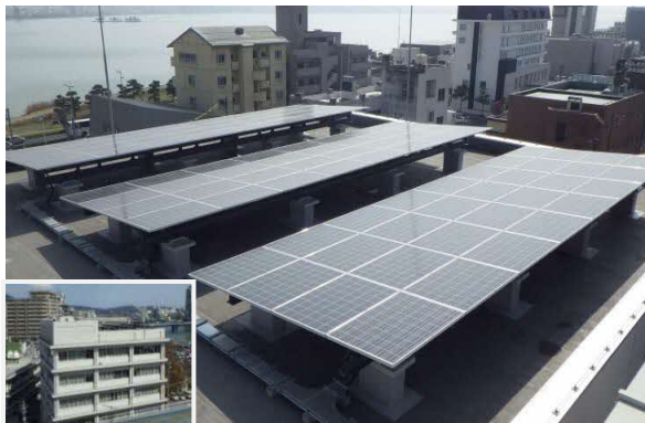
■図表 2-4 公共施設太陽光発電 (2013 年度設置：市本庁舎西棟)
