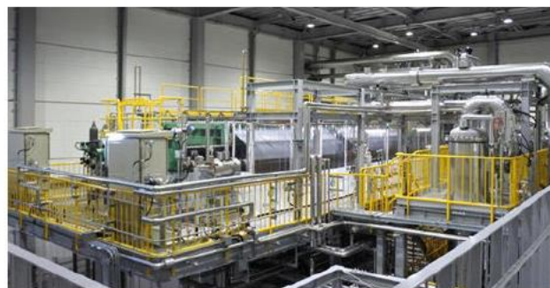
10MWの水電解装置
