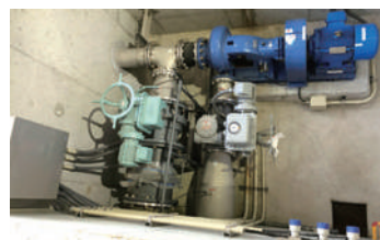
小水力発電設備(乃白ポンプ場)
