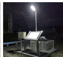
太陽光発電・蓄電システム導入事例 (松江市総合運動公園)
