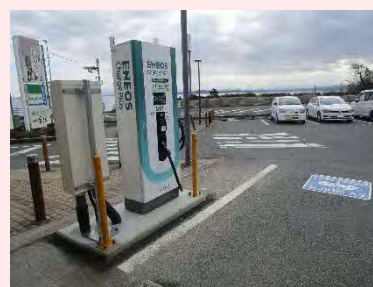
【電気自動車用急速充電器】
