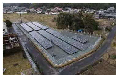
【太陽光発電（竹矢ポンプ場）】
