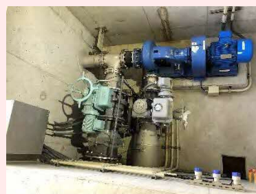
【小水力発電設備（乃白ポンプ場）】
