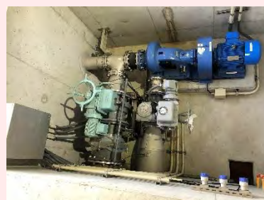
【小水力発電設備（乃白ポンプ場）】
