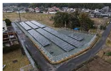
【太陽光発電（竹矢ポンプ場）】
