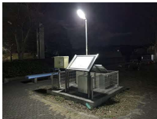
【太陽光発電・蓄電システム導入事例 （松江総合運動公園）】
