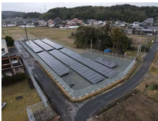
【太陽光発電導入事例（竹矢ポンプ場）】
