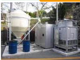
木質ペレット焚冷暖房機・給湯器 9基
