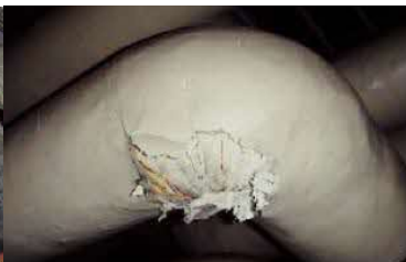
エルボ部に使用 石綿含有保温材
