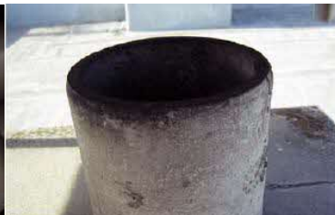
煙突の内側に使用 石綿含有断熱材
