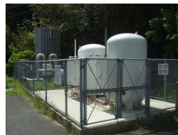
バルク貯槽(手前)と バーパーライザー(強制気化装置)(奥) (写真: イングリッシュガーデン)
