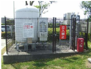
バルク貯槽 (写真: 総合体育館)
