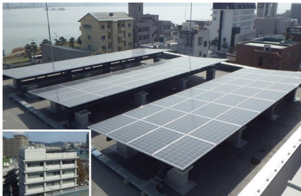
■図表 2-4 公共施設太陽光発電 (2013 年度設置：市本庁舎西棟)
