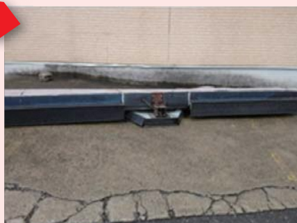
落下した欄間看板
