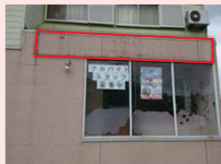
落下した後の壁面
