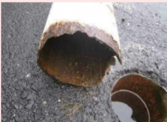
ポールの根腐れによる倒壊
