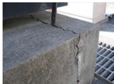
看板基礎のひび割れ
