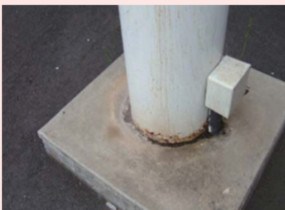
ポールの根元にサビが発生
