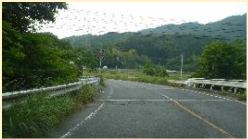
▲改善前写真 Before
