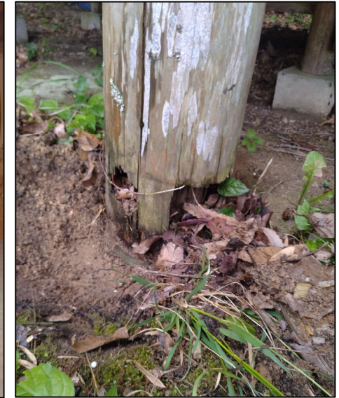
(柱の腐朽状態)
